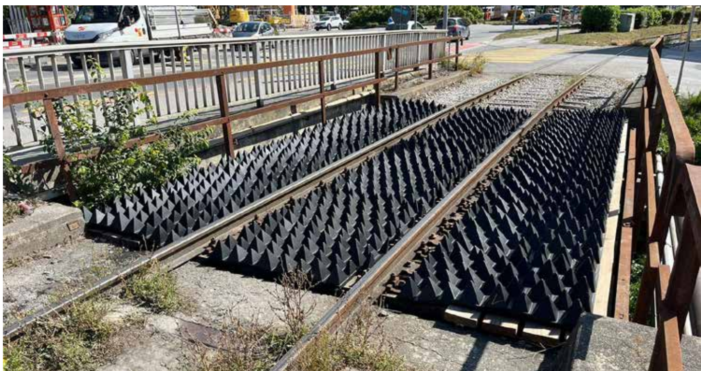
Image 4: Pont du Canal après l'installation des éléments STRAILgrid , plus possible de traverser le pont.
